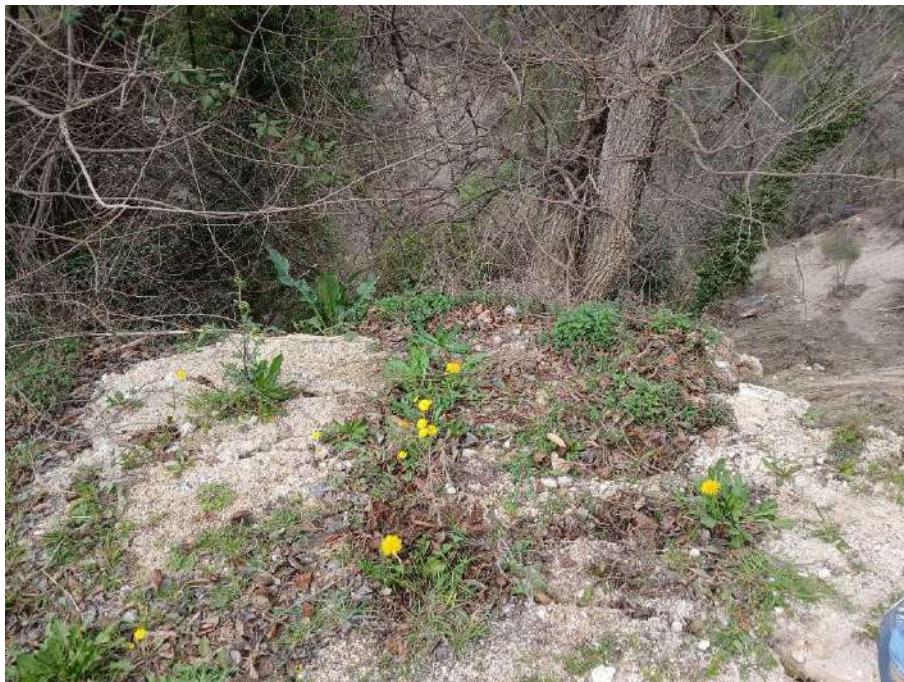
Figure 12 : couronne fracturée instable en aval de la rue du Soustet (09/03/2026).
