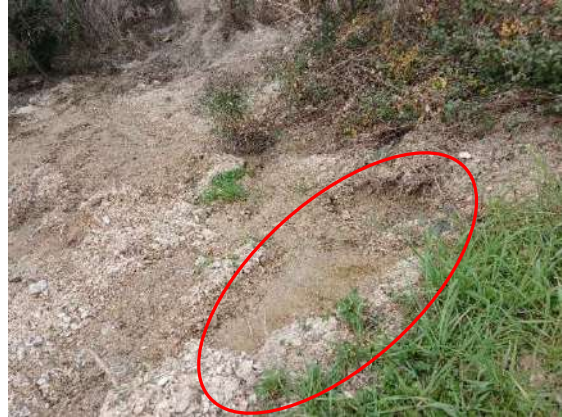
Venue d'eau ponctuelle à la base des remblais
