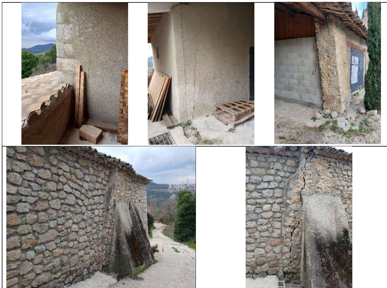
Figure 9 : structure endommagée de l'ancienne remise de la parcelle n°B 811 (09/03/2026).
