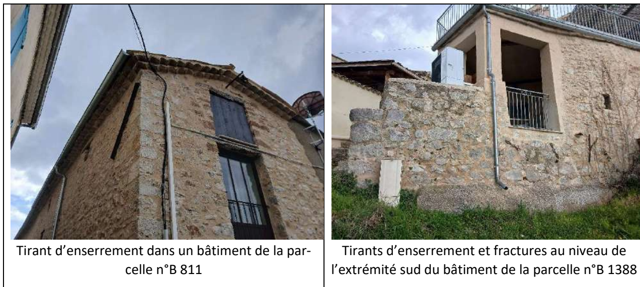
Figure 11 : exemples de désordres affectant les bâtiments du hameau des Jonchiers (09/03/2026).
