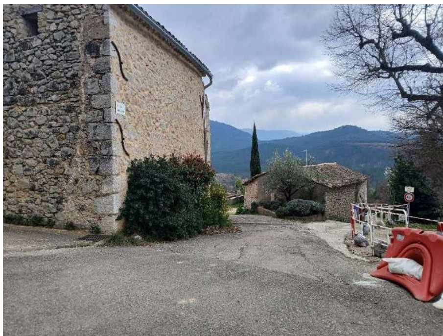
Figure 13 : fissuration ancienne de la chaussée de la rue du Soustet (09/03/2026).
