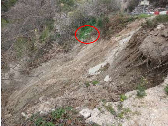
Partie supérieure de la cicatrice avec tuyau PVC du drain nord-ouest
