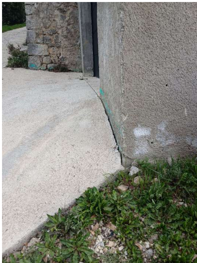
Figure 10 : décollement entre la rampe et le seuil du nouveau garage de la parcelle n°B 360 (09/03/2026).
